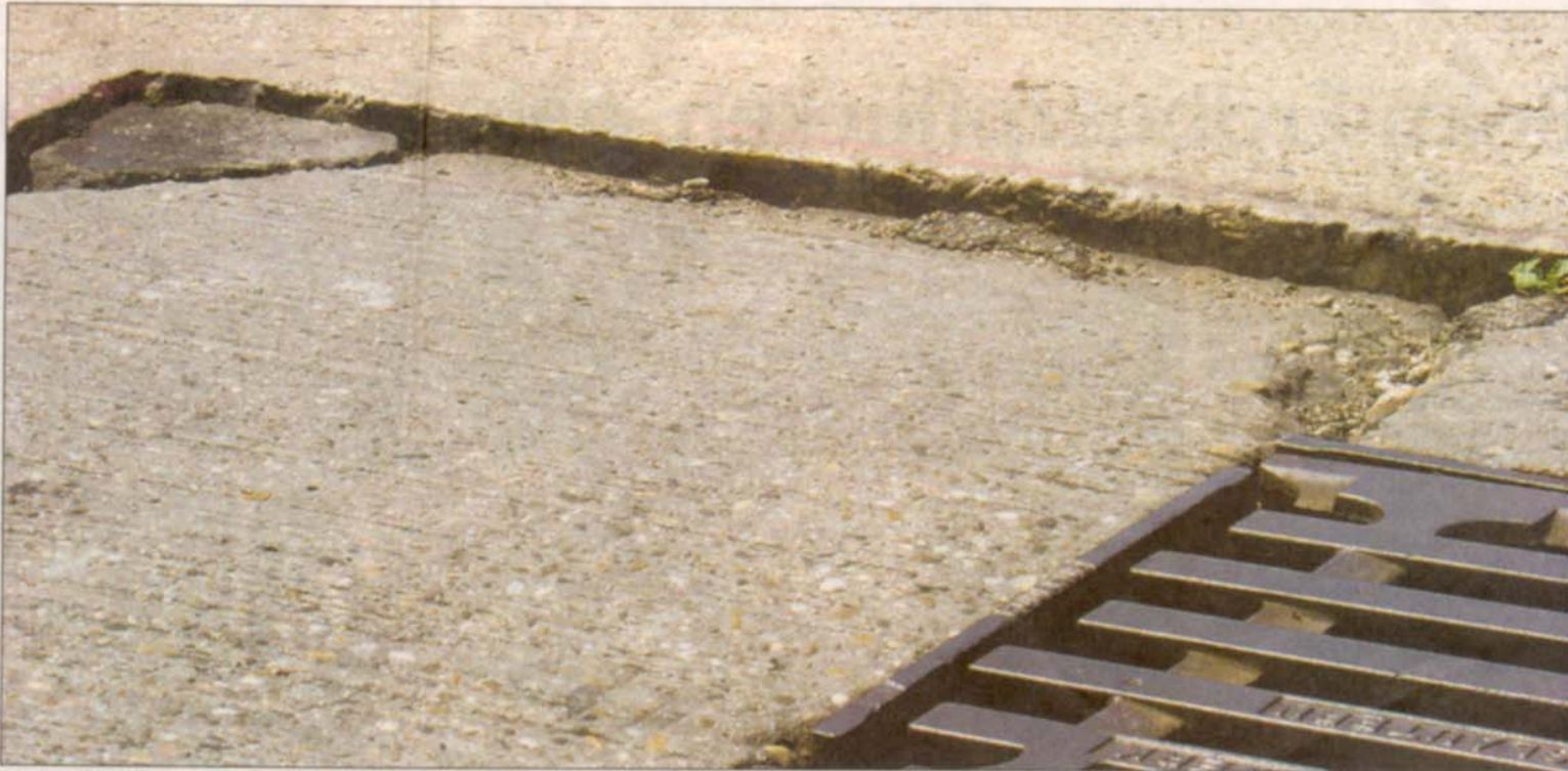
Zerbrochene Betonplatten wie hier auf der Karl-Wüst-Straße sind ein klassischer Fall für die Arbeitskolonnen des Heilbronner Betriebsamts. Nun müssen die Bauarbeiter den Beton großflächig aufschneiden, ausbauen und neuen Asphalt in drei Lagen einbauen. (Fotos: Andreas Eberle)
